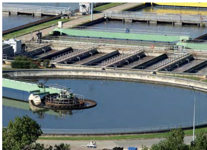
Stazione di pompaggio.
